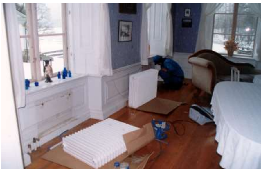
Fig 18. Bidrag till standardhöjande åtgärder får inte utgå enligt bidragsförordningen. Därför tillhör det ovanligheterna att bidrag lämnas till värmeinstallationer. I byggnadsminnet Ölsboda aktualiserades frågan av att inredningen hotades av förstörelse på grund av avsaknad av fungerande uppvärmning. En sjövärmepump och radiatorer för vattenburen värme installerades därför år 2003. Foto: Mia Geijer. Länsstyrelsen i Örebro.
