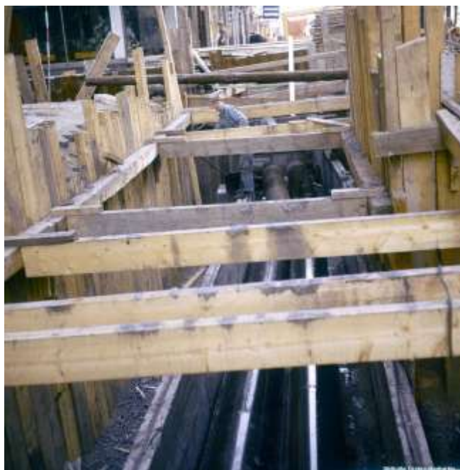
Fig 6. Utbyggnad av fjärrvärmesystem i de svenska städerna innebar omfattande gatuarbeten. Här dras fjärrvärmeledningar under Fredsgatan i Örebro i början av 1960-talet. Fotograf okänd. Örebro Stadsarkiv.
