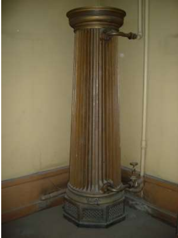
Fig 1. Kolonnformad Radiatorer installerades i Gamla Riksarkivet i Stockholm som färdigställdes år 1890. Valet av värmesystem byggde på tidigare erfarenheter och noggranna överväganden kring såväl drift som komfort. Foto: Mia Geijer
