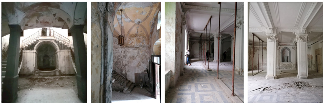
Fig. 2. State of decay of 'Edifici Mondo' (Credits: Mariarosaria Angrisano, Martina Bosone, Antonia Gravagnuolo).
