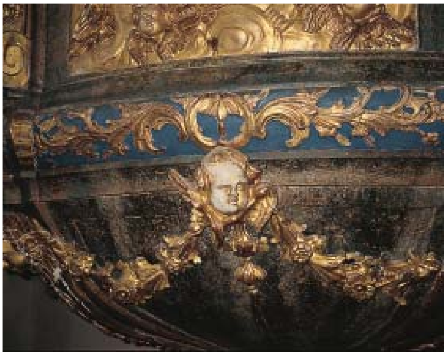
Förgyllning som torkats bort med fuktig trasa, Tensta kyrka, Uppland. Vatten och förgyllning går inte ihop.
