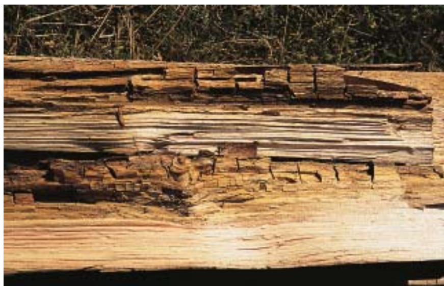
Angrepp av brunröta på en kluven stock. Angreppet är begränsat till de missfärgade bruna områdena, där veden under upptorkning har spruckit i karakteristiska kuber.
