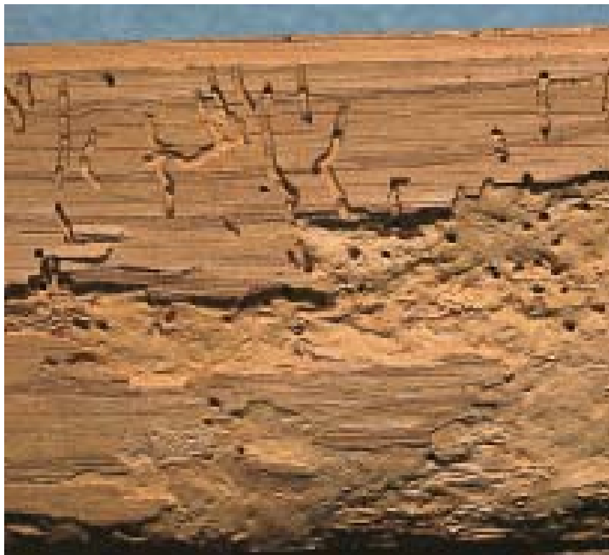
Skador på ekparkett orsakade av splintbagge.
