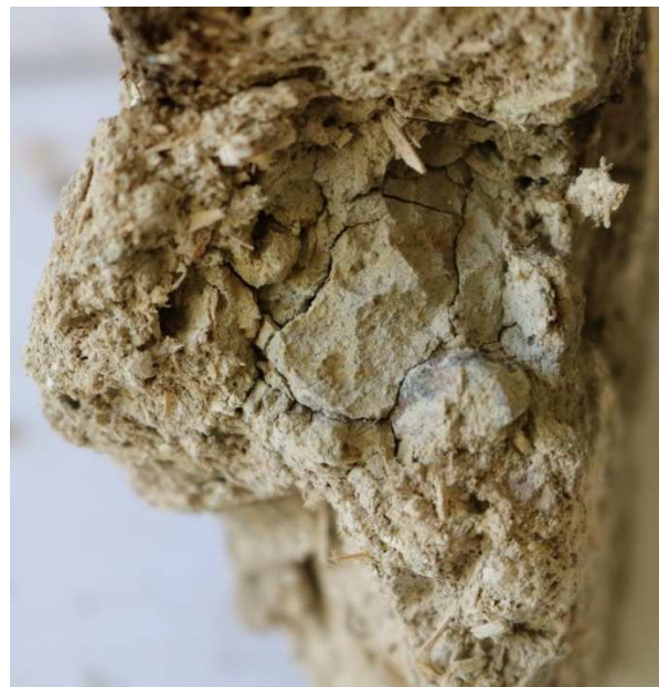
Figur 5. Bruk från S:ta Gertrud 8. På den västra fasaden finns en tjock lerputs under de yttre lagren av kalkputs och cementputs. I lerlagret som är omkring 5 cm tjockt finns stora lerklumpar och armering av vad som troligtvis är halm. Foto: Sofie Nygren
