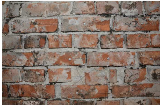
Figur 14. Där skadad puts har avlägsnats har även del av asfaltbeläggningen – framförallt i fogar – avlägsnats. Små lagningar fästs med ett armerande virrvarr av ståltråd som putsbärare. Foto: Kristin Balksten
