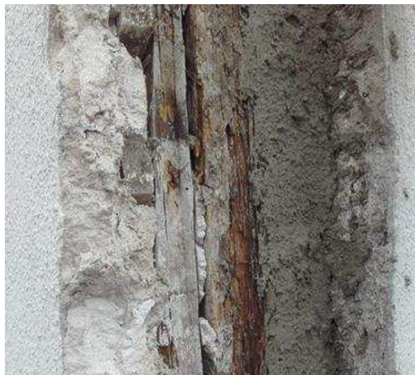
Figur 23. S:t Klemens 9. Hörnstolpen har ruttnat där det tidigare var en mur. Troligtvis finns liknande skador på många andra byggnader. Foto: Sofie Nygren
