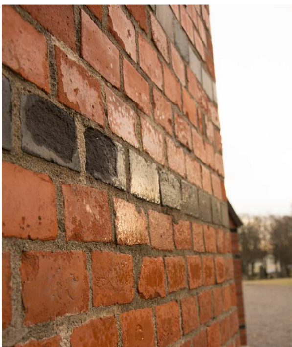
Figur 48. En hydrofoberad yta på Högsätters kyrka där det syns hur vatten pärlar sig på hela tegelytor. Här är dock många vittrade tegelytor som vittnar om att vittringen är en ständigt närvarande process och då är hydrofoberingen inte lämplig eftersom det kan ge ökad vattenbelastning på skadade fläckar.
