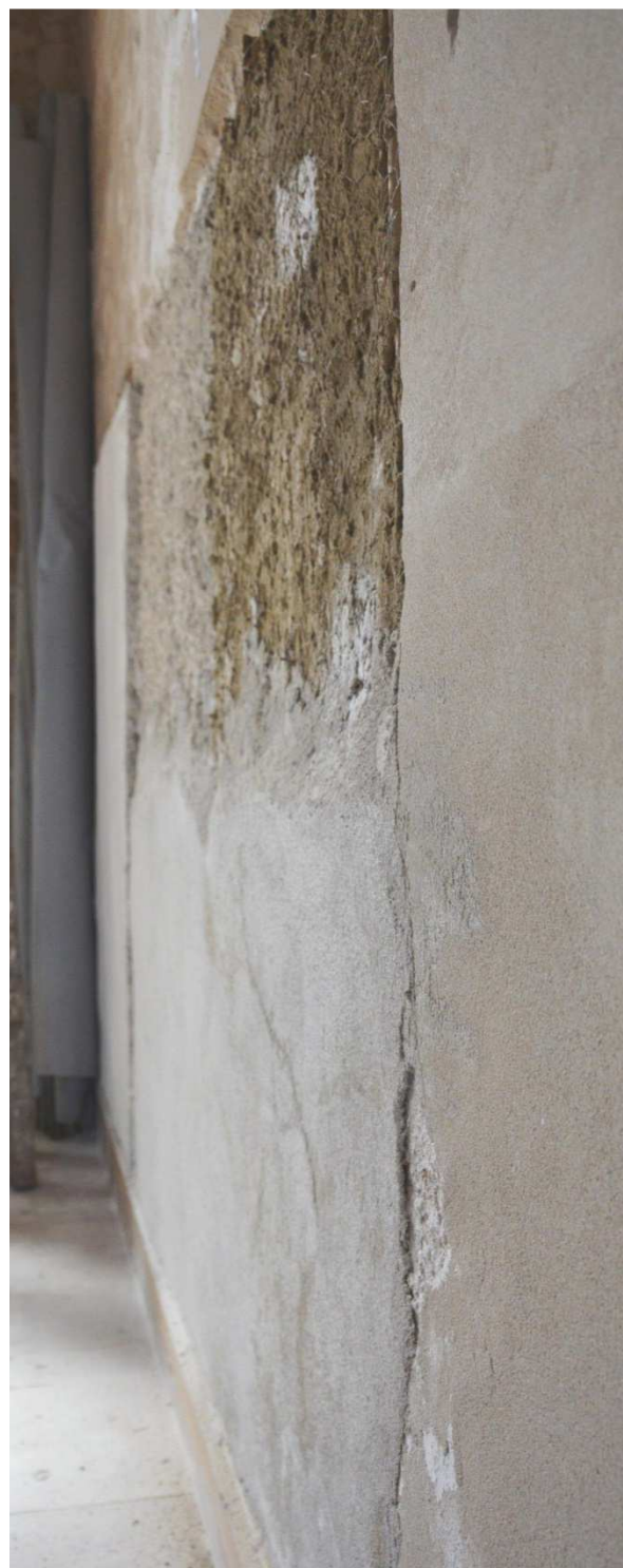
Figur 5. Salterna har gått igenom lerputs lagret men på hampakalken och dess putsyta syns inga salter som avsatt sig på ytan.
