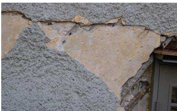
Figur 22. S:ta Gertrud 8. Den hårda cementputsens har bitit sig hårt fast i den underliggande spritputsens. Cementputsens och spritningen lossnar i stora sjök från det släta undre putslagret. Foto: Sofie Nygren
