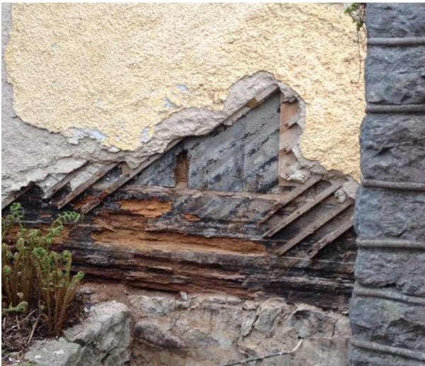
Figur 19. Röttskadad stomme bakom puts-skada. Foto: Kristin Balksten
