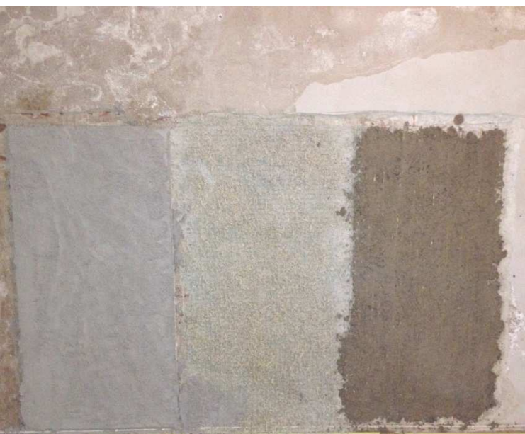
Figur 3. Första påsletet fick torka i ett par veckor innan ytputsen slogs på.
