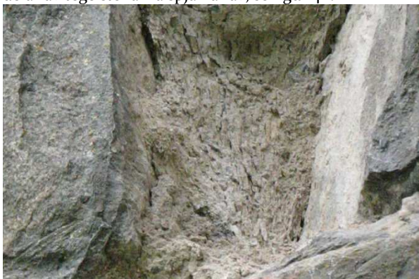
Figur 37. När kalkmurbruk fryser sönder bildas ett karakteristiskt mönster när det spjälkar/flagar i skikt.
