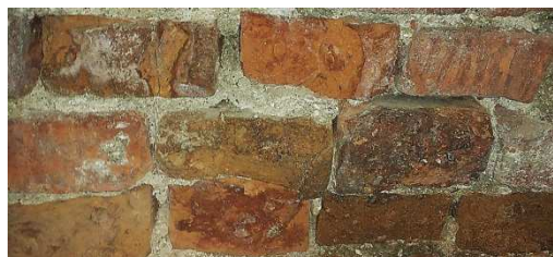
Figur 4. Tegelvalv i källaren på Skoklosters slott. Slarvigt lagt koppförband. Foto: Lotta Lindley (med tillstånd)
