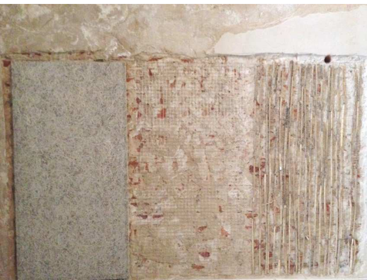
Figur 2. Det putsbärande skiktet; 1) träullit, 2) putsnet och 3) vassmatta. Dessa sitter dikt an mot tegelmurverket som frilagts bakom den saltvittrade putsen.
