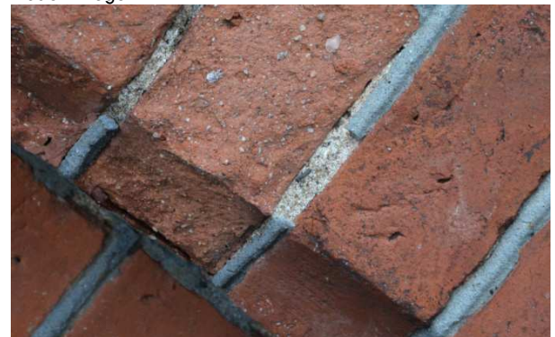
Figur 5. Dragen originalfog på Umeå stads kyrka. Den yttre cementfogen av gråpigmenterat bruk är ytterst tunn och ligger utanpå det ljusare kalkmurbruket.
