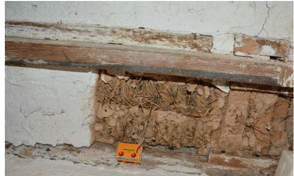
Figur 16: Lerstakar i taket på Hovdala slott, som underlag för lerklining i taket. Foto: Kristin Balksten
