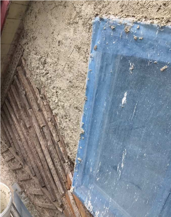
Figur 8. Hampakalk under påförande. Hampakalken bygger så bra att det räckte med ett påslag som fyllde mellan och utanpå ribborna. Foto: Anna Donarelli
