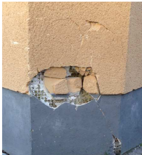
Figur 17. Tilläggsisolering med mineralull och KC-puts. På den här typen av fasad syns ofta mekaniska skador. Foto: Kristin Balksten
