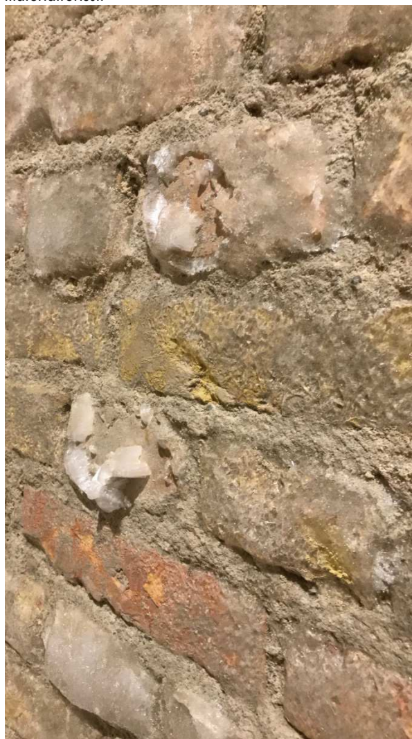
Figur 41. Ishinna som täcker hela insidan av Sjömansstrunns torn i Göteborg en vinterdag. Här har iskristallerna kunnat bilda dels ett pansarlager av is och dels trådformade kristaller om ca 2 cm.
