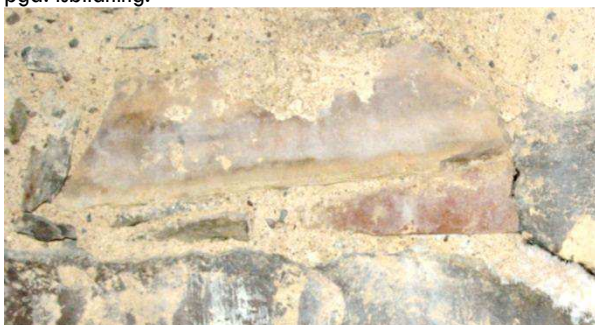
Figur 39. Ishinna som täcker en tegelsten invändigt i Tösse kyrktorn. På graniten har inte samma effekt uppstått utan det är från vattenmättat tegel som isen kunnat bildas.
