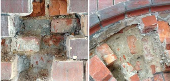
Figur 47. Här visas hur fukt som ansamlas inuti murverket ger upphov till så kallad murröta; tegelstenarna har frusit sönder och delar sig medan kalkbruket har antagit karaktären och egenskaperna av blöt sand. Exempel från Örgryte nya kyrka.
