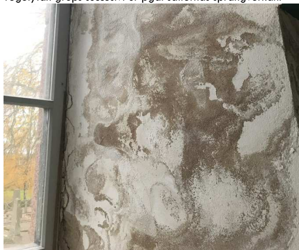
Figur 16. Saltrosor på cementputs. På en stark och tät puts syns sulfaterna som mörka saltrosor där färgen sprängts bort och putsen mörknat som vore den blöt.
