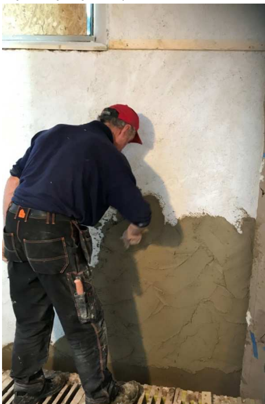
Figur 21. Ytputsen har här gjorts av ett infärgat kalkbruk som appliceras direkt på hampakalken, vilken har god sugförmåga som ger bra vidhäftning. Foto: Kristin Balksten
