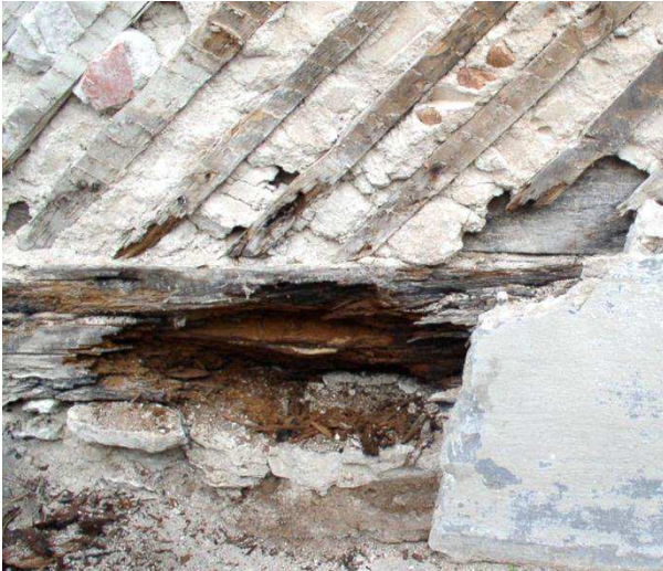
Figur 18. Röttskadad syll bakom tät betongsockel. Foto: Kristin Balksten
